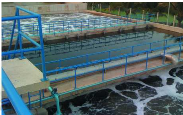
Hệ thống xử lý nước thải tập trung KCN Amata
