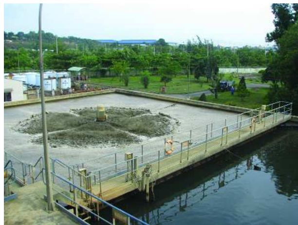
Hệ thống xử lý nước thải tập trung, KCN Biên Hòa 2
